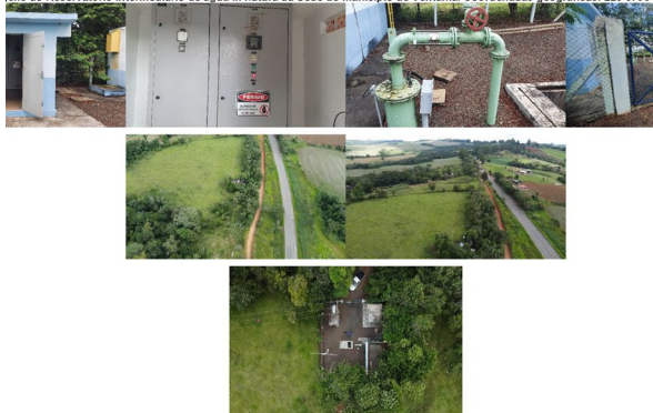
Figura 3 - Imagens do Reservatório Intermediário de água in natura da Sede do Município de Ventania. Coordenadas geográficas: 22J 57964
